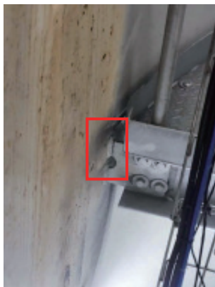
图 1 某风场平台损坏现状
