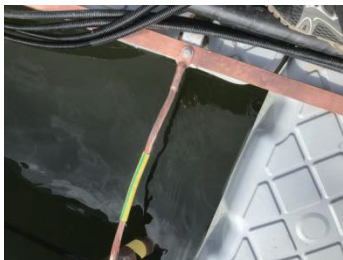
图 3 包塑镀铜钢绞线腐蚀情况
