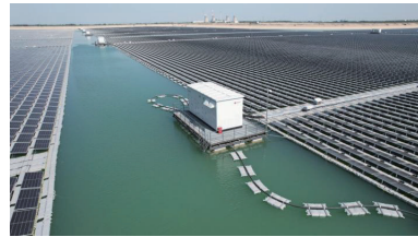
图 6 天津某浅海漂浮光伏电站
