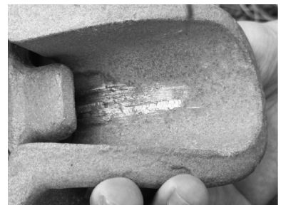
图 3 #237 塔导线悬垂线夹磨损
