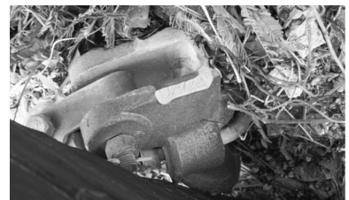
图 4 #237 塔导线悬垂线夹断裂
