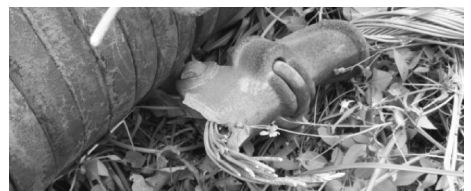
图9 断裂的悬垂线夹
