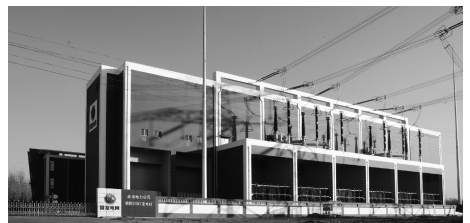
图 4 我国第一座全户内 500 kV 变电站 Fig. 4 The First 500 kV Indoor Substation in China
