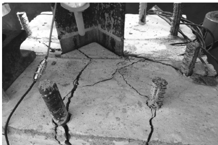
图 6 C 类试件的劈裂破坏
