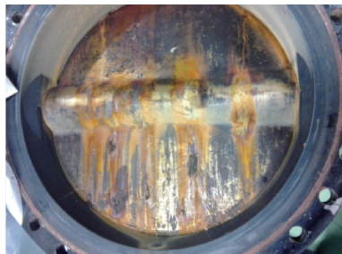
图 1 换热器近端蝶板腐蚀图
