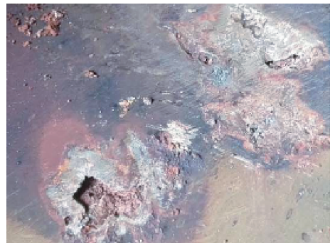
图6 蝶板腐蚀外貌
