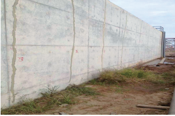
图1 水池池壁裂缝现场状况
