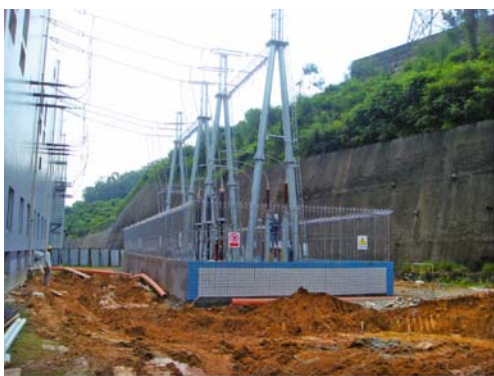
图1 传统电缆终端场一
