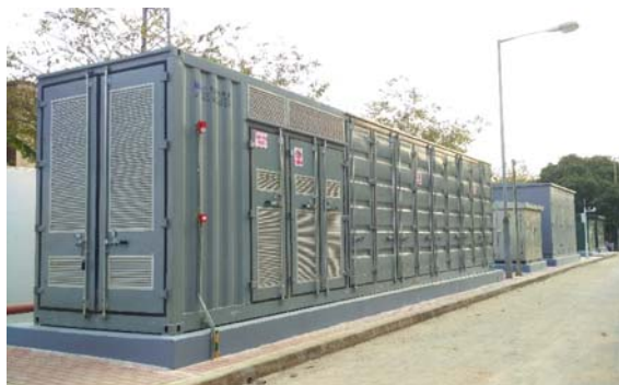
现场储能集装箱实例
