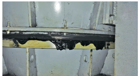
图 1 旋转清堵机动静结合部漏润滑油
