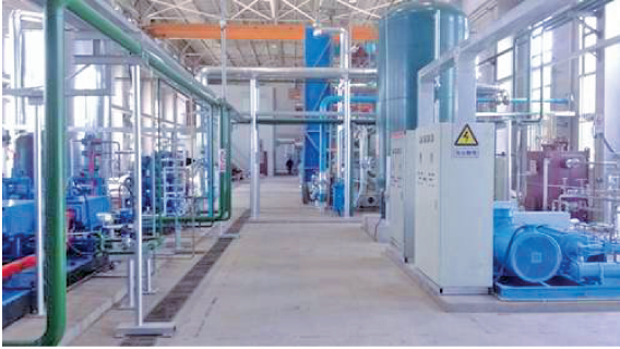
图9 廊坊 1.5 MW 超临界压缩空气储能示范
