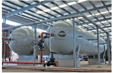
(b) 压缩空气储罐
