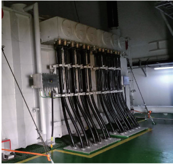
图8 主变低压侧电缆连接方式
