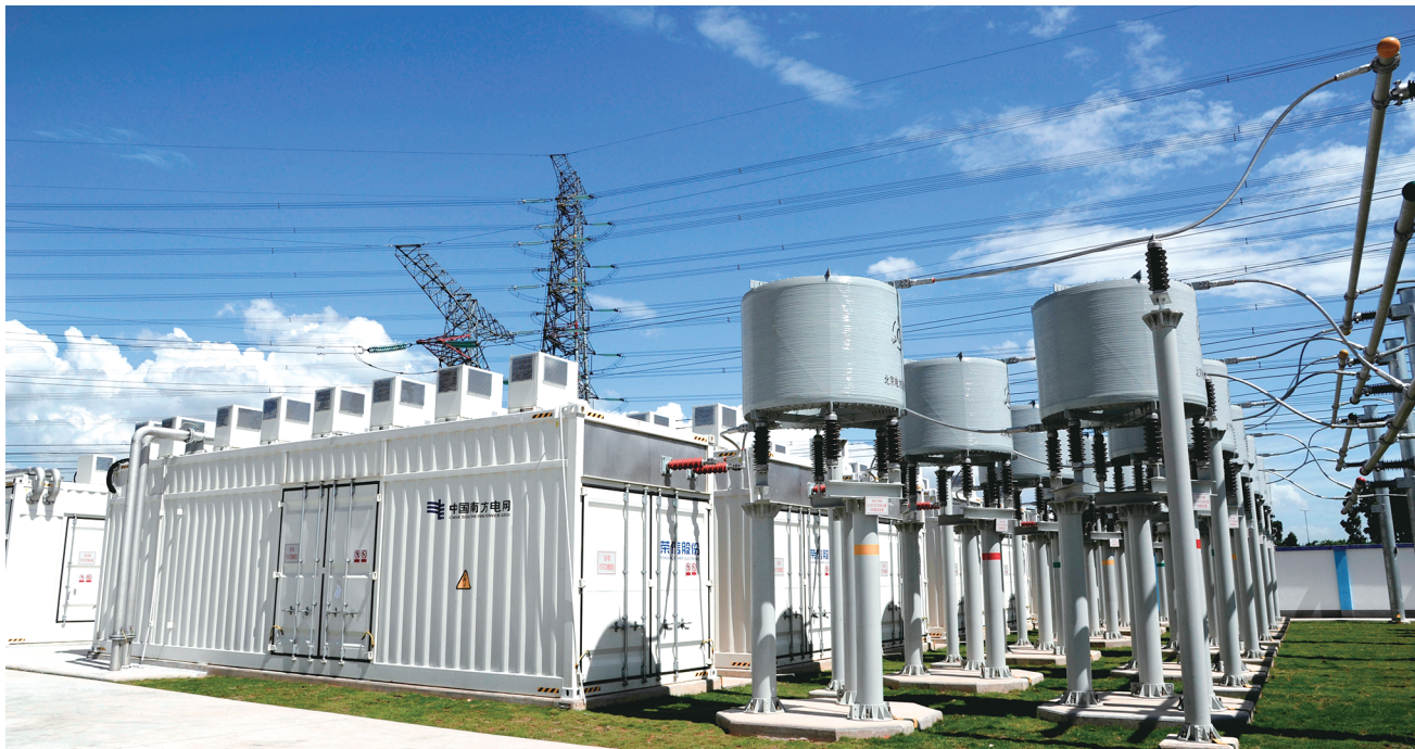
500 kV 水乡变电站
