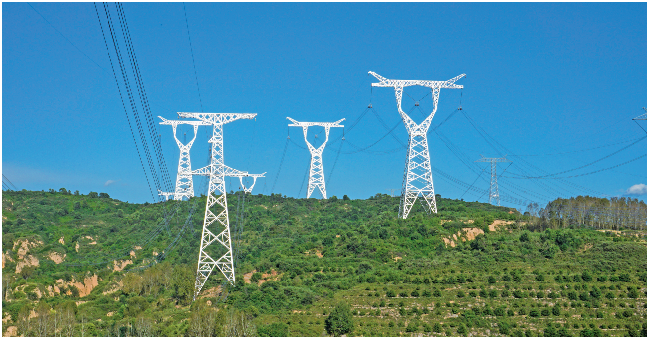
输横 ~ 潍坊 1000kV 特高压交流输电工程(设计)
