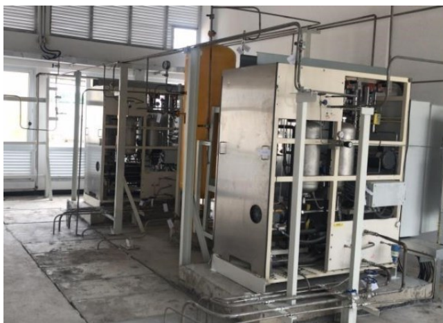
电厂电解水制氢装置
