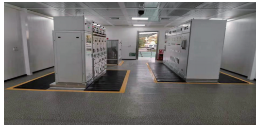
图5 沙边配电站现场图
