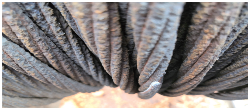
架空地线锈蚀样貌图
