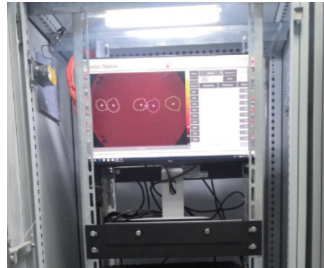
图8 机柜及现场系统温度场实景图
