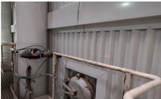
图 4 红外炉膛烟温测量装置安装实景照
