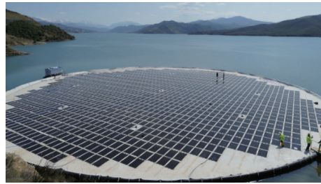
图 6 Banja 项目漂浮式光伏系统
