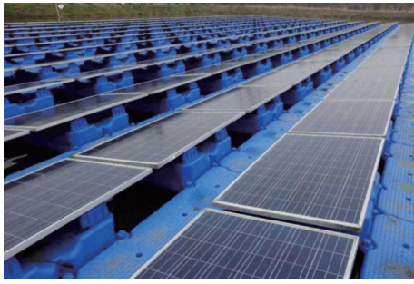
图 3 浮筒式漂浮光伏电站
