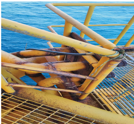
图9 干湿交替区域焊点腐蚀
