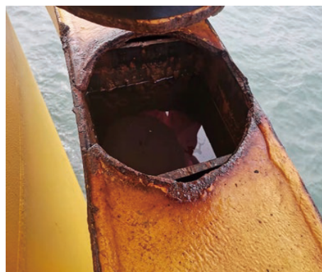
图 5 积水区域焊缝腐蚀破坏
