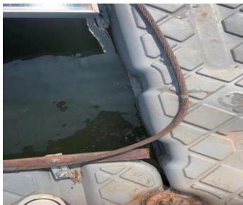
图 2 镀铜钢绞线腐蚀情况
