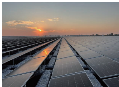
图 1 漂浮式光伏电站
