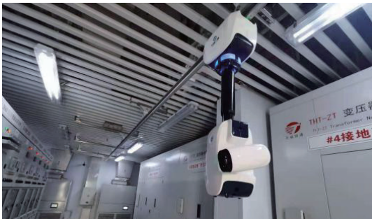
图 11 35 kV 开关室巡检机器人
