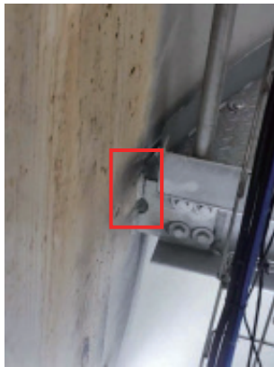
图 1 某风场平台损坏现状
