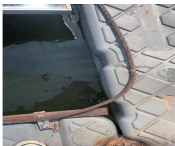
图 2 镀铜钢绞线腐蚀情况
