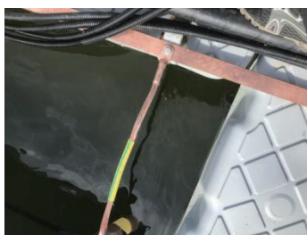
图 3 包塑镀铜钢绞线腐蚀情况
