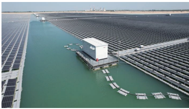
图 6 天津某浅海漂浮光伏电站
