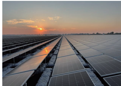
图 1 漂浮式光伏电站
